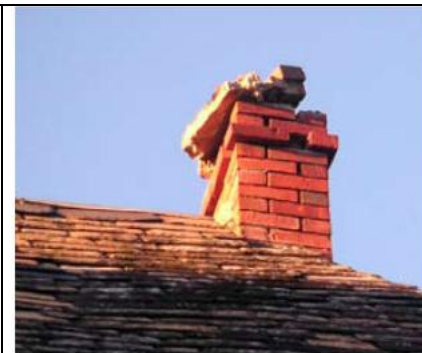
Châteaux de cheminées fragilisés à Arrayou-Lahitte (8,5 km de l'épicentre) - photos DDE65
