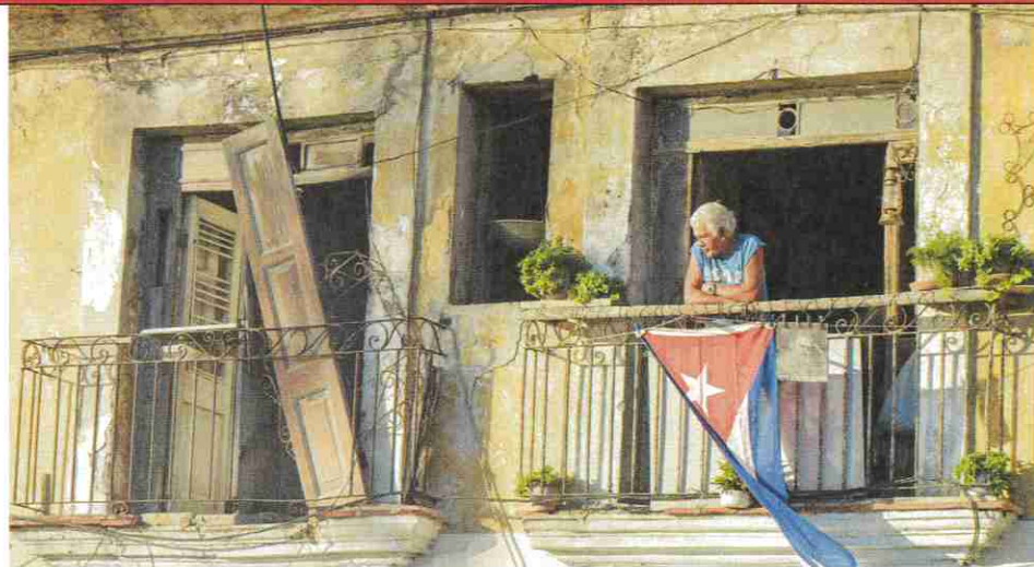
La Habana se derrumbe. Más de 850.000 estructuras habitadas en Cuba requieren mantenimiento y reparaciones, según las autoridades del país. (Sipa)
