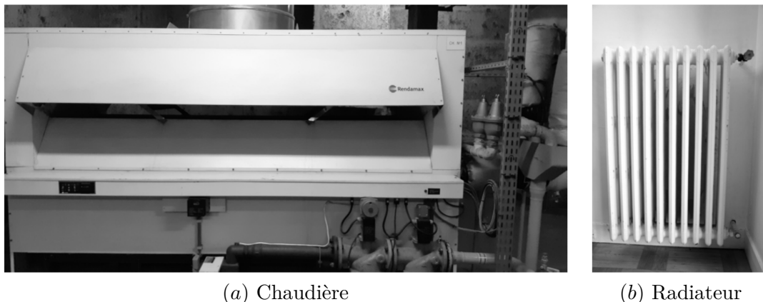
FIGURE 6 – Le chauffage est assuré par une chaudière centrale à gaz (a). L'énergie thermique est transférée aux logements par de l'eau chauffée à environ 70^\circ\text{C} circulant dans des radiateurs en fonte (b).
