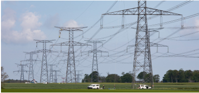
Ligne haute tension
