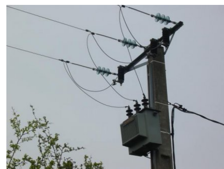
Transformateur en 230 V
