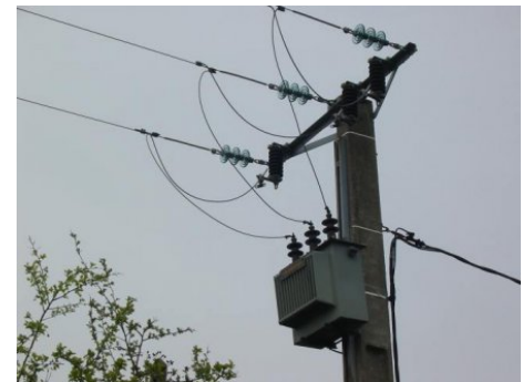
Transformateur en 230 V
