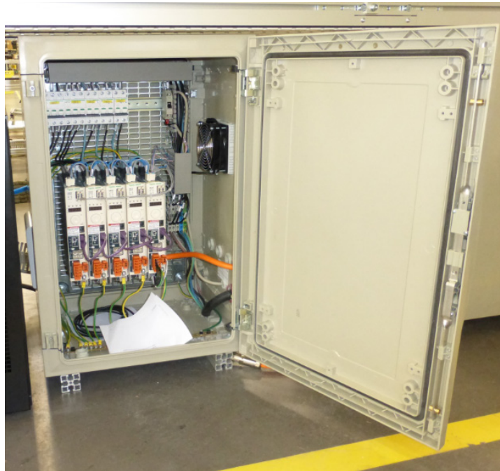
Vue de l'armoire de commande
