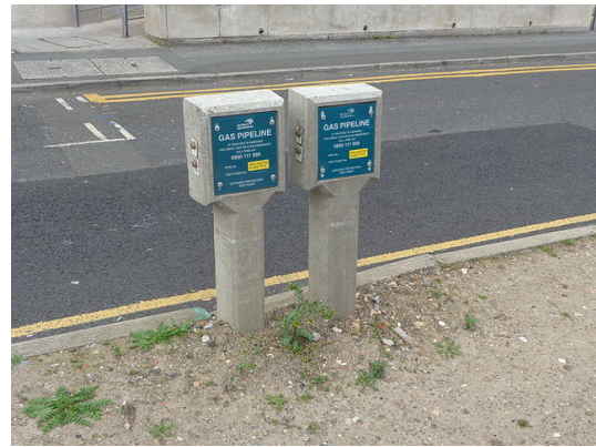
marqueurs de protection cathodique sur un gazoduc
