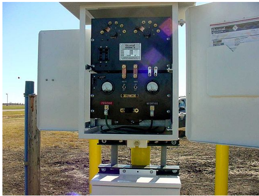
générateur pour protection cathodique relié à un pipe-line
