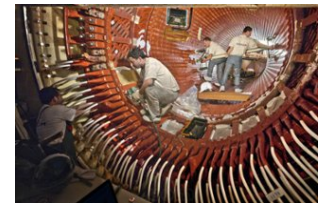
FIGURE 6 – L'alternateur d'une centrale nucléaire est un peu plus gros...
