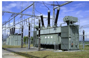
FIGURE 4 – Un transformateur de puissance dans un poste électrique.
