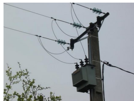
Transformateur en 230 V
